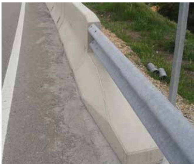
Transición instalada CORRECTAMENTE.
