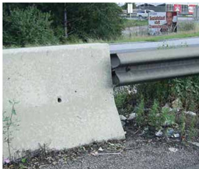
Transición instalada INCORRECTAMENTE.
